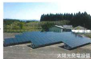
太陽光発電設備
