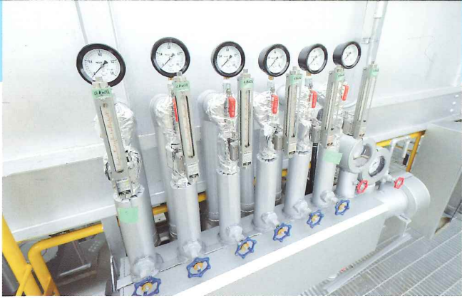
22 熱利用温水回収設備 冷却ストーカに通水した水を熱交換し、温水として利用します。
