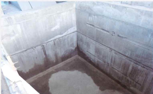
10 ミキシングピット 廃プラスチック類、その他廃棄物と汚泥をミキシングし、混合物として組成を調整します。
