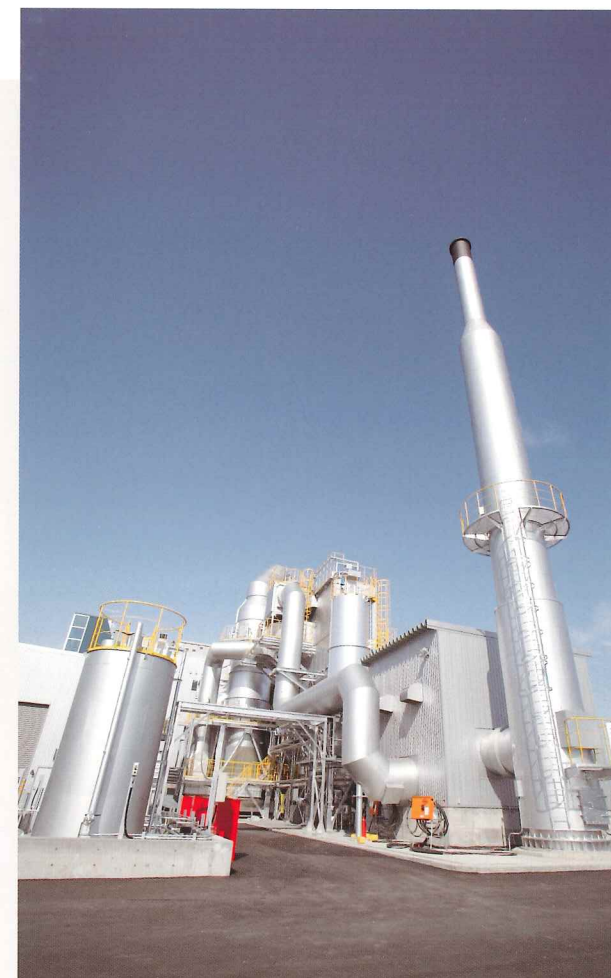
⑥ 公害発生防止施設 排ガスに含まれるばいじん、HCl、SOX、ダイオキシン類 を規制値以上に処理するバグフィルタ乾式有害ガス 除去装置等から構成されています。
