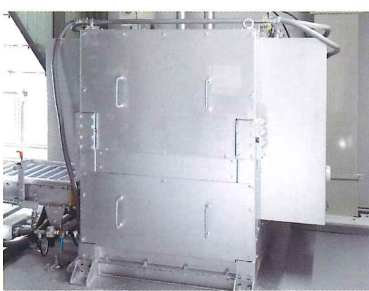
16 感染性廃棄物昇降機 他の廃棄物と分離した状態で 炉内まで感染性廃棄物を搬送 します。
