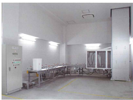
14 感染性廃棄物搬送装置室 感染性廃棄物の保管・空調管理を行い、 廃棄物の菌が増殖しないよう低温を保ちます。
