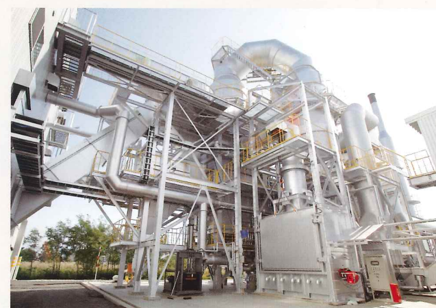
⑤ 焼却施設／熱利用施設 廃棄物を焼却処理するストーカ焼却炉、二次燃焼室、 ドラム缶炉から構成されています。
