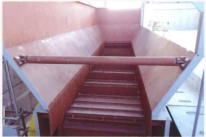
13 供給コンベヤ 水平・傾斜、二段のコンベヤで構成されています。廃棄物の貯留と焼却炉内への供給を行うエプロンコンベヤです。
