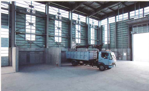
9 混合物貯留ヤード 搬入された廃棄物を各ピットに保管します。
